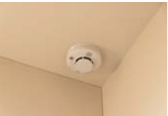
火災報知器 (電池式)
