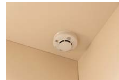
火災報知器(電池式)
